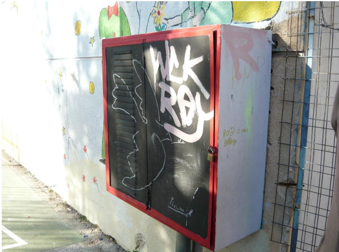
Εικόνα 2. Πίνακας Μετρητή ΔΕΗ
