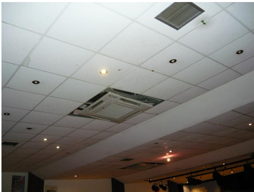
Εικόνα 13. Κασέτες κλιματισμού ΑΠΧ
