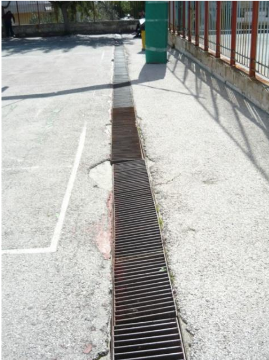
Εικόνα 10. Σχάρες αυλείου χώρου
