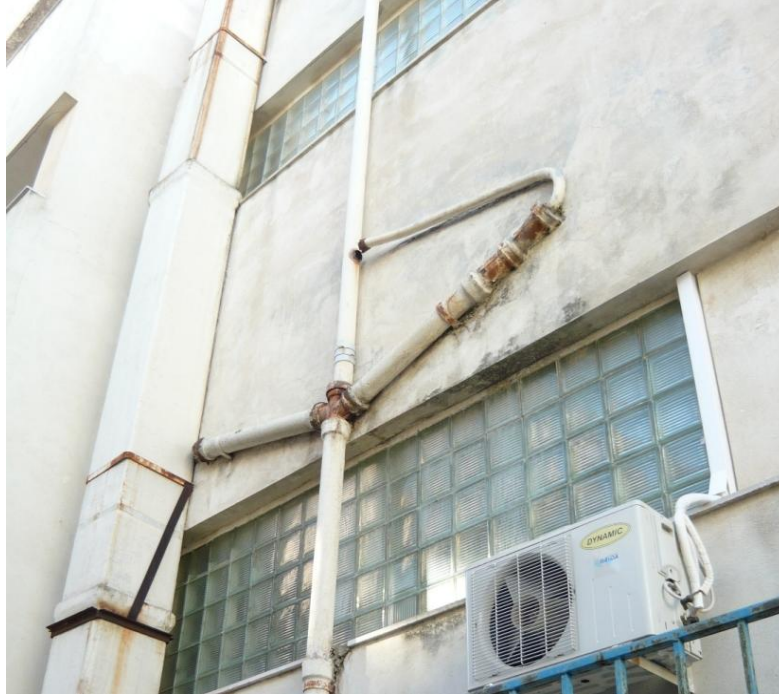
Εικόνα 3. Σωλήνες εξαερισμού WC
