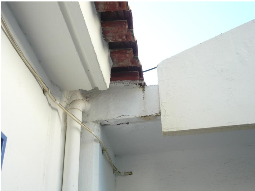
Εικόνα 16. Υγρασίες σε υδροροή
