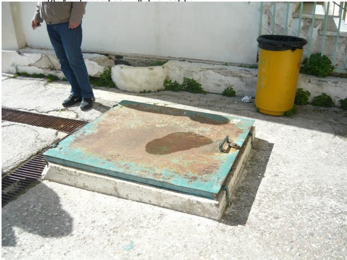
Εικόνα 9. Φρεάτιο κεντρικής θέρμανσης
