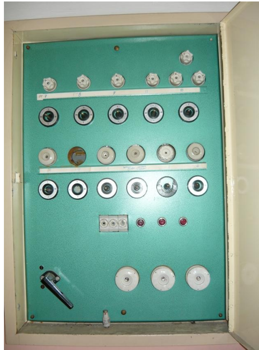
Εικόνα 18. Γενικός ηλεκτρικός πίνακας
