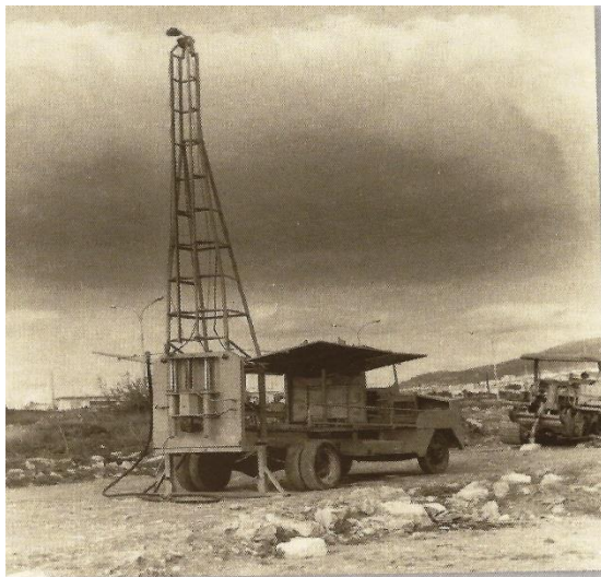
Εργασίες για την κατασκευή του Υδραγωγείου στην Αργυρούπολη, στα μέσα της δεκαετίας του 1950
