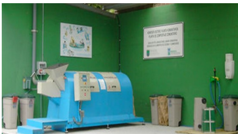
Εικόνα 11: Μηχανικός κομποστοποιητής εγκατεστημένος σε υπόγειο πολυκατοικίας
